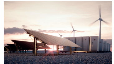
Energieerzeugung und -speicherung
