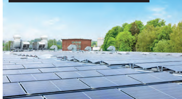
Photovoltaikanlage im Werk Wipperfurth
